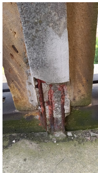
Schäden an der Balustrade auf dem Turm
